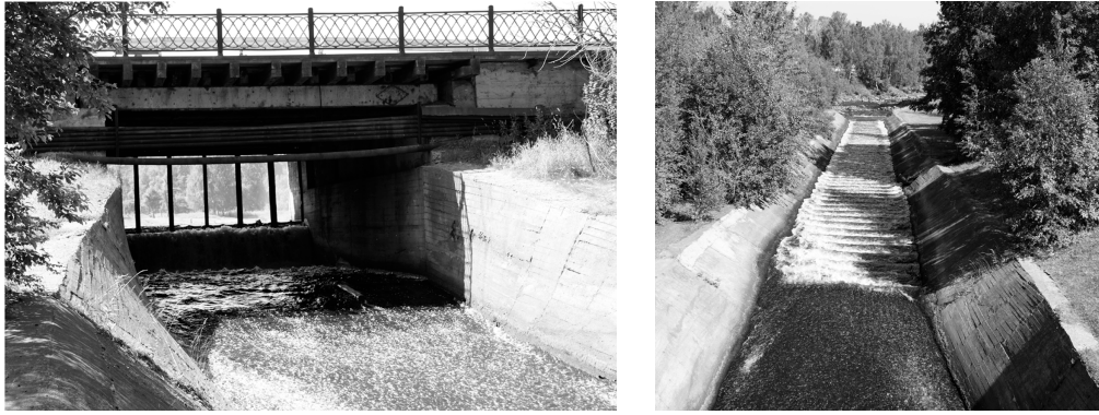
Рис. 2. Плотина и быстроток в 480 м выше устья. Фото И. А. Тыркина
